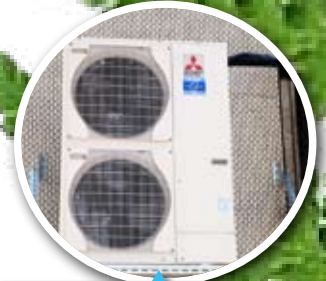
空調設備採用變頻機組
