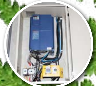
冷卻水塔節能改善
