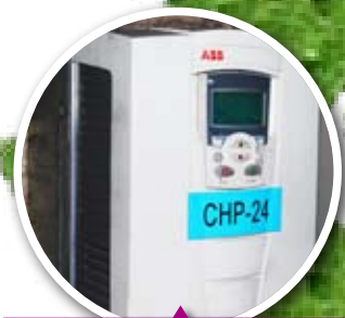
區域冰水泵採變頻控制
