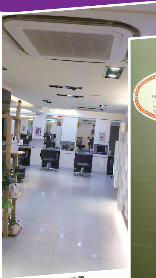
基礎照明使用LED燈具
