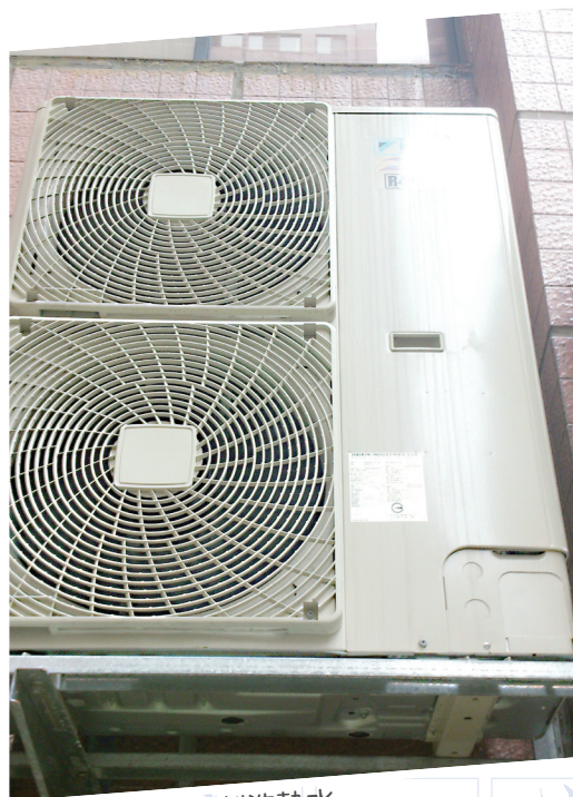
使用氣對水熱泵製造熱水
