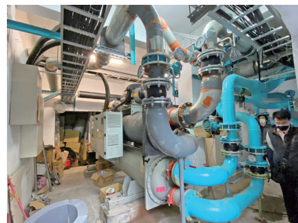
採用變頻磁浮式冰水主機
