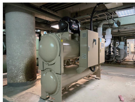
採用變頻離心式冰水主機
