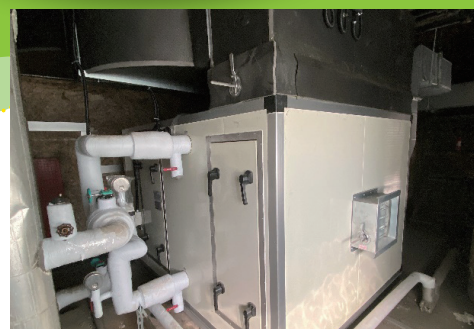
汰換空調箱並新增變頻控制
