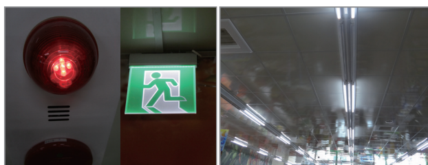
緊急指示照明採LED燈具 賣場採用高效率LED燈具
