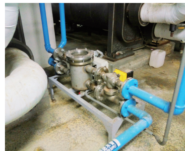
冰水主機冷凝器加裝自動清洗裝置
