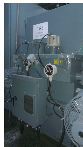
採用高效率變壓器
