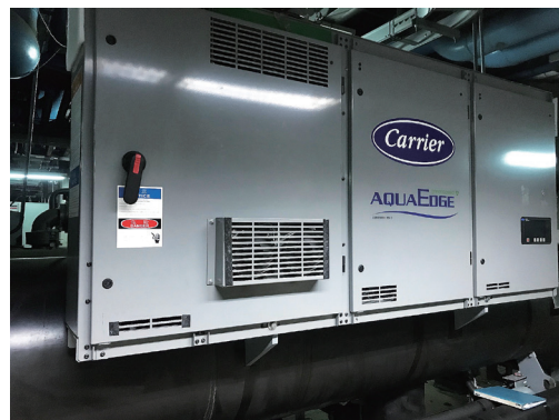
高效率空調主機提高製冷效率
