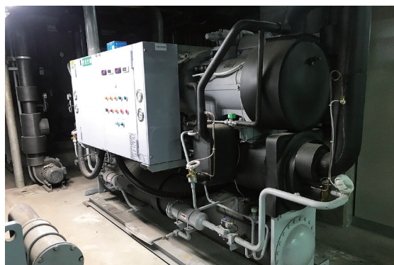
雙效熱泵製熱取代鍋爐系統
