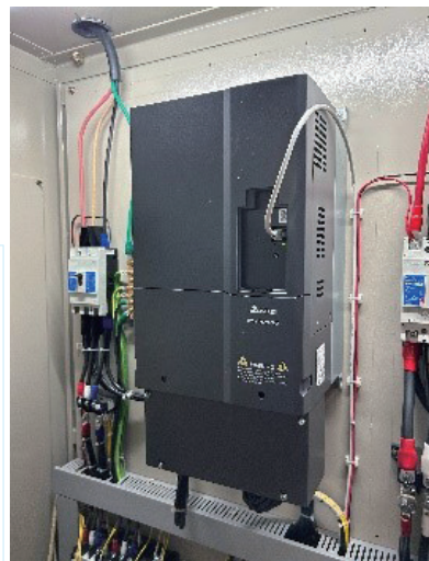
既設冰水泵、冷卻水泵及冷卻水塔加裝變頻控制
