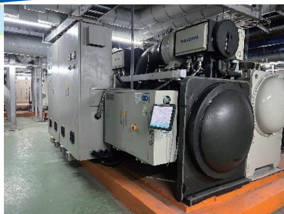
新設之1000RT變頻磁浮離心式冰水主機
