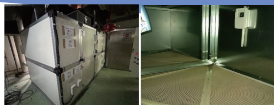
新設之固態轉輪全熱交換器
