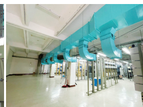
機房高溫引出風口及側吹改善
