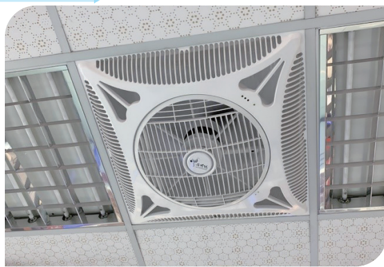
增設循環扇，提高冷氣溫度不低於26℃
