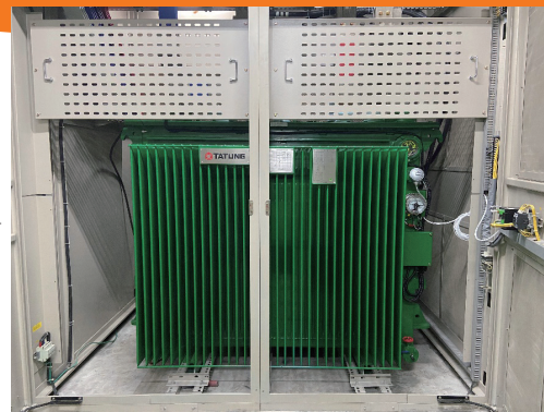
採用高效率非晶質變壓器
