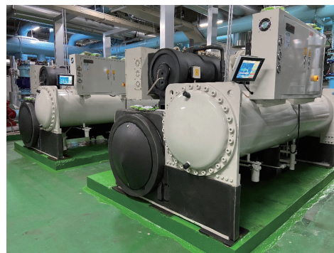
採用離心式變頻冰水主機
