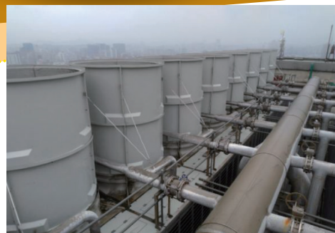
冷卻水塔更新與變頻控制
