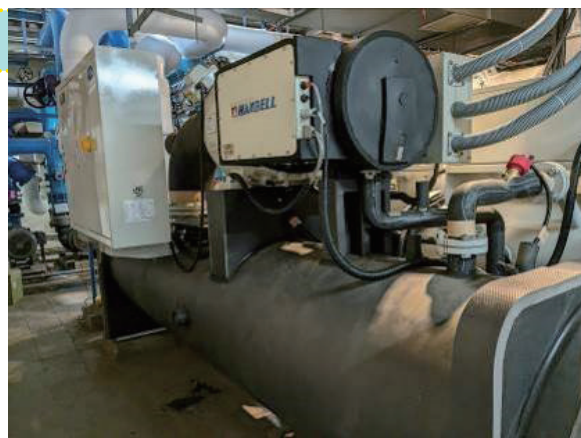
新設之350RT變頻磁浮離心式冰水主機
