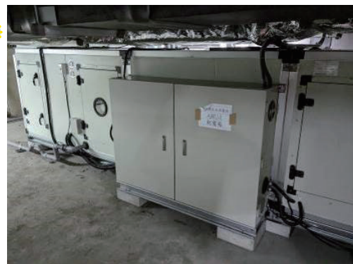
新設之空調箱及吸附除濕設備
