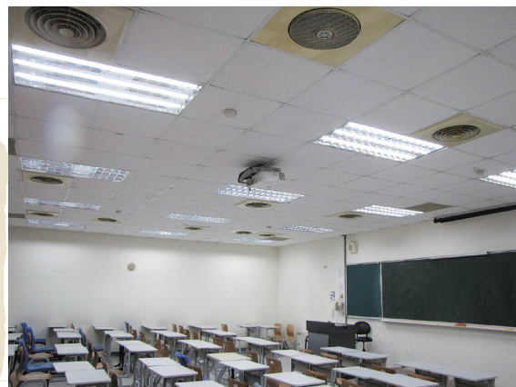
一般教室LED照明設備
