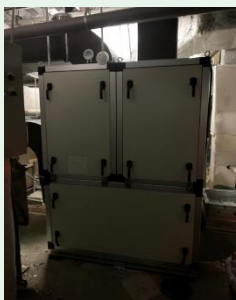
實際安裝照片
