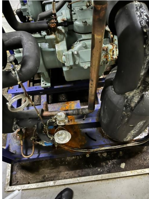
圖 4-22 主機支架鏽蝕狀況
