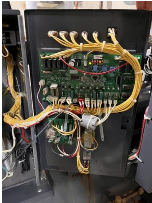
圖 4-7 壓縮機控制機板
