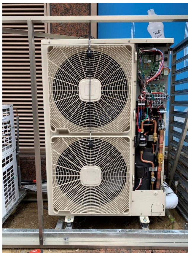
圖 4-18 室外冷凝側主機實體圖
