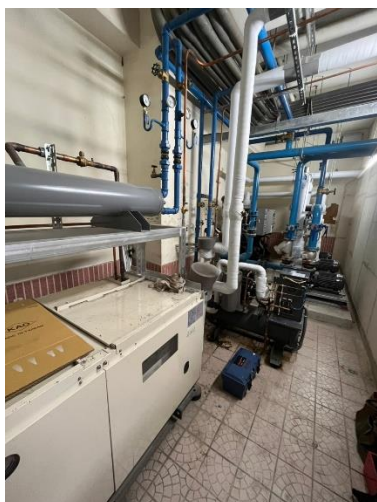
超市冷凍空調機組
