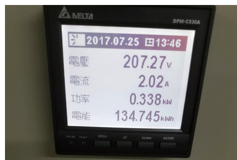
電梯電力回生裝置電表
