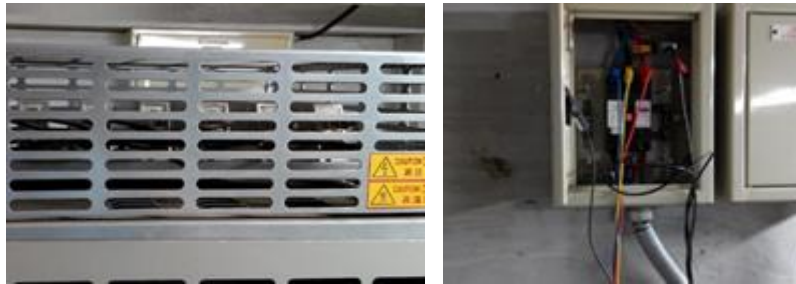
圖 6.2-3 電梯電源端實際量測及制動電阻裝設現況
