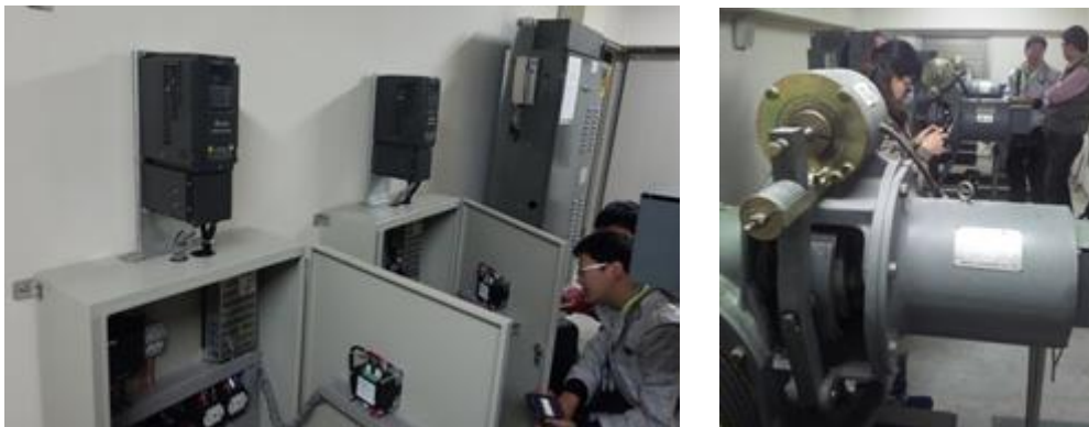
圖 6.2-8 電梯電力回生裝置偕同現場管理人及維保廠商實測
