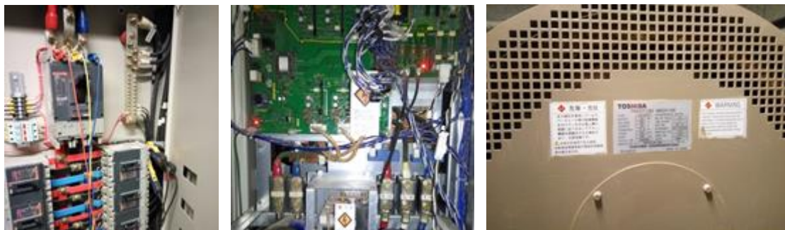
圖 6.2-10 電梯電力回生裝置實測現況
