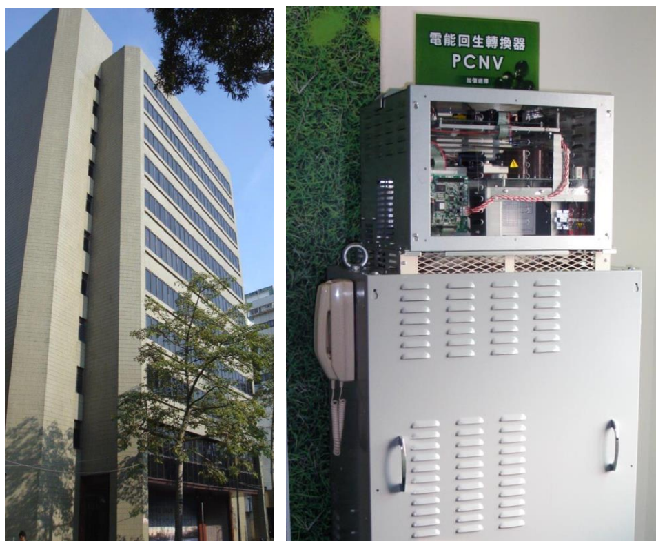
圖 6.4-2 電梯電力回生裝置節能案例現況實照
