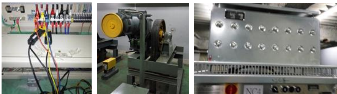
圖 6.2-9 電梯電力回生裝置實測現況
