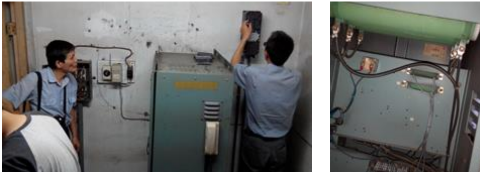
圖 6.2-7 電梯電力回生裝置偕同現場管理人及維保廠商實測
