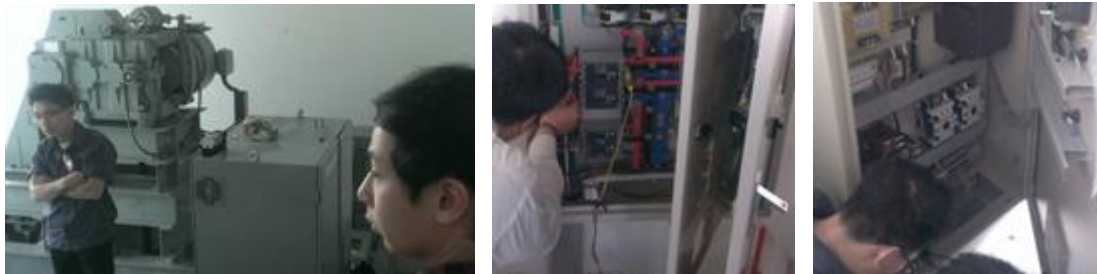
圖 6.2-6 電梯電力回生裝置偕同現場管理人及維保廠商實測
