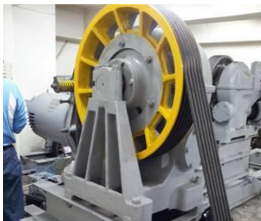
圖 6.4-6 電梯電力回生裝置節能案例現況實照
