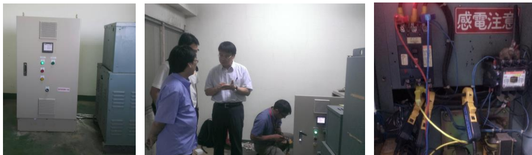
圖 6.2-11 電梯電力回生裝置實測現況
