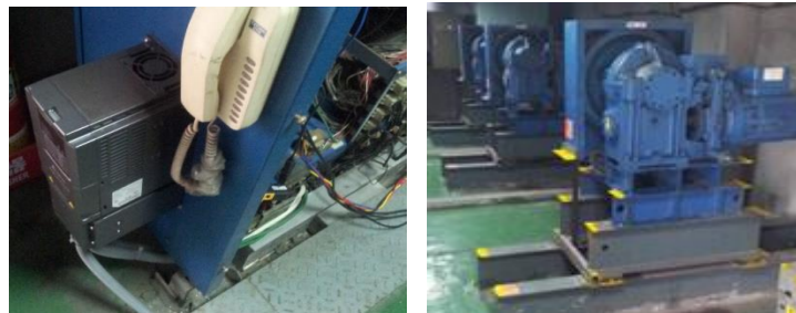
圖 6.2-2 電梯機房及電力回生裝置裝設點
