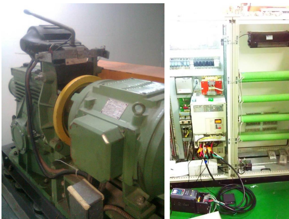
圖 6.4-7 電梯電力回生裝置節能案例現況實照
