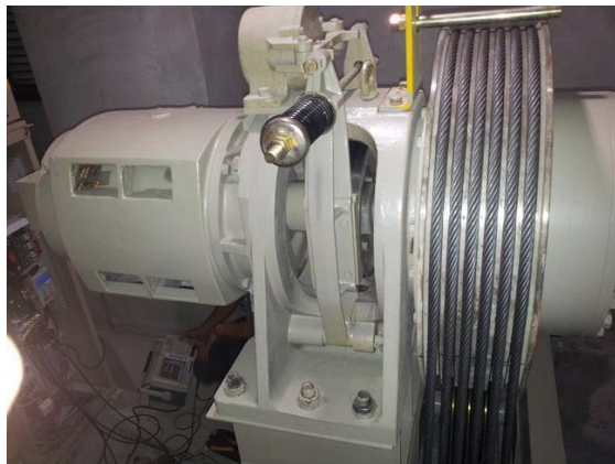
圖 6.4-5 電梯電力回生裝置節能案例現況實照
