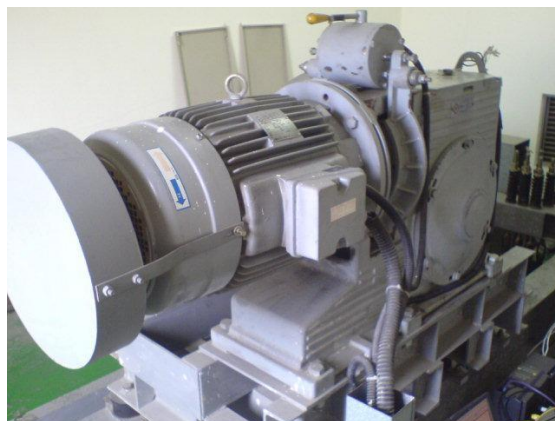
圖 6.4-4 電梯電力回生裝置節能案例現況實照
