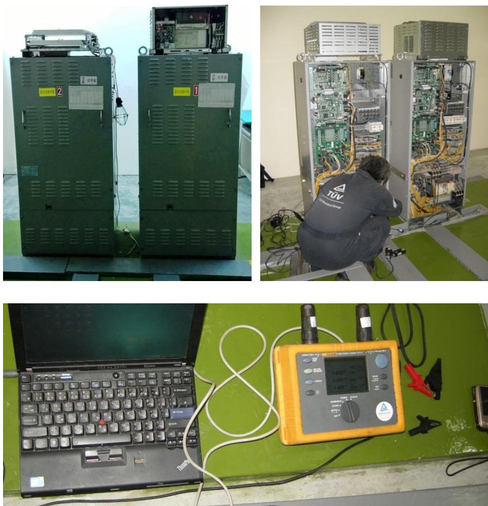
圖 6.4-3 電梯電力回生裝置節能案例現況實照
