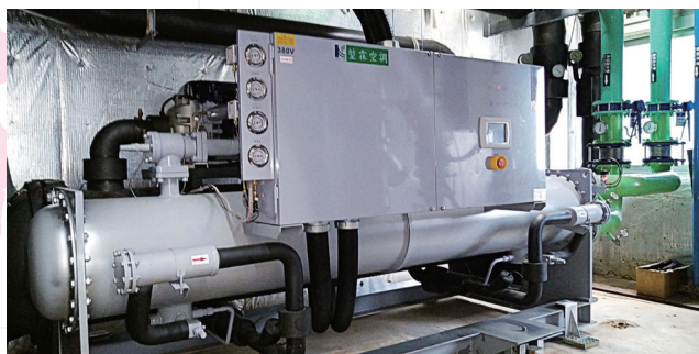
採用磁浮離心式高效率空調主機
