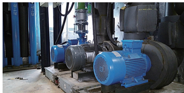
冰水、冷卻水泵加裝變頻器
