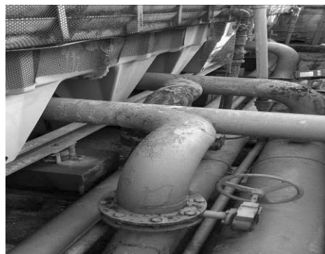
水塔管路腐蝕嚴重情況
