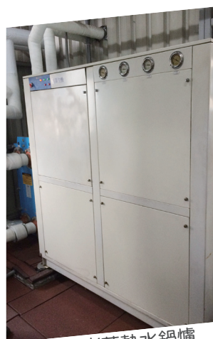
熱泵取代老舊熱水鍋爐
