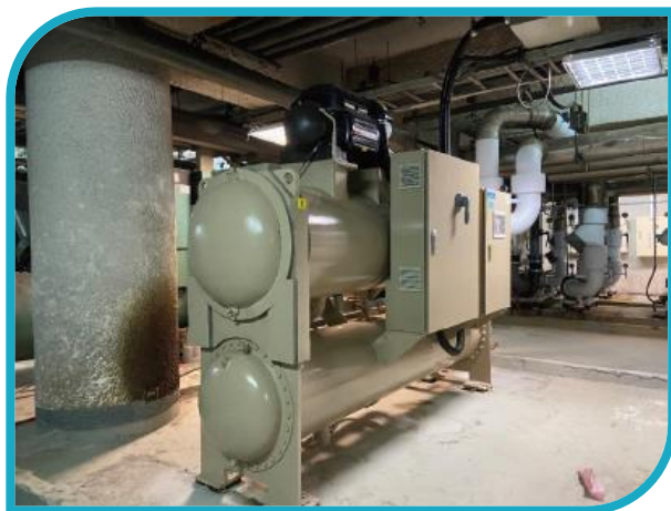
採用變頻離心式冰水主機
