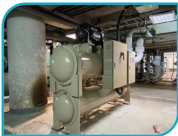
採用變頻離心式冰水主機
